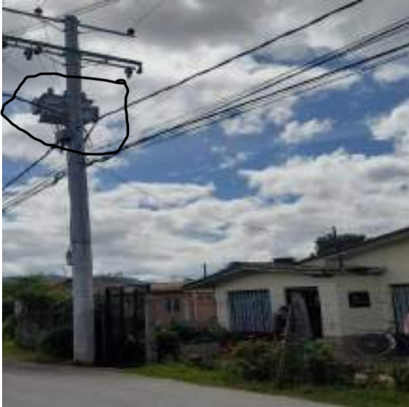
Contador averiado sector las juntas
