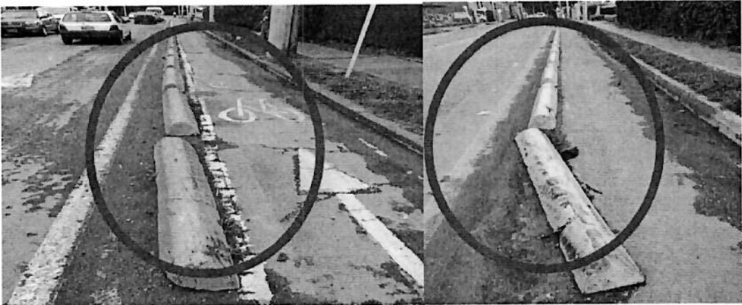
*Imágenes del deterioro de la ciclorruta en el municipio de Chía
