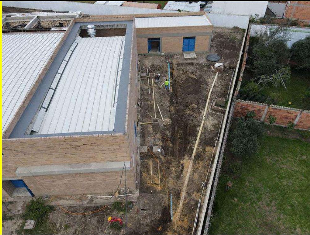
Visual zona posterior de bloques 2 y 5 de equipos y bombas
