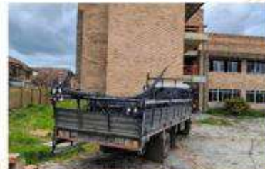
Fotografía No.4 Llegada de acero para los tanques.
