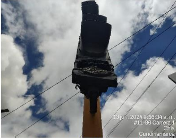
CARCASA PARA CAMBIO -ACCESO ORIENTE
